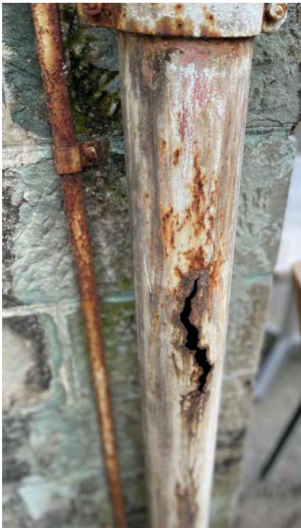
Schäden an der Hülle
