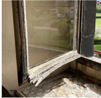
Dégradation de l'enveloppe
