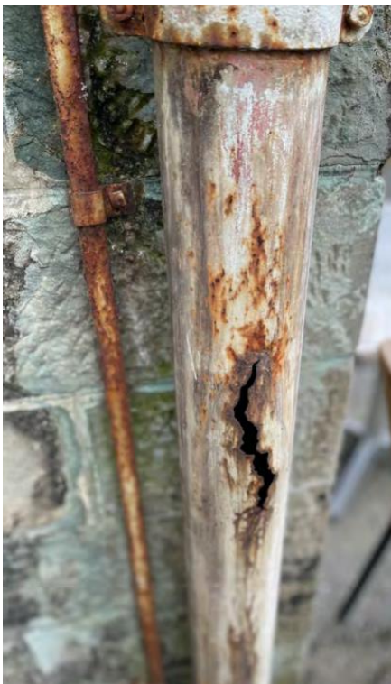
Dégradations de l'enveloppe
