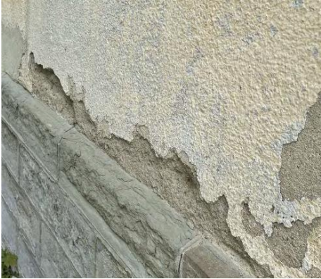
Dégradation de l'enveloppe
