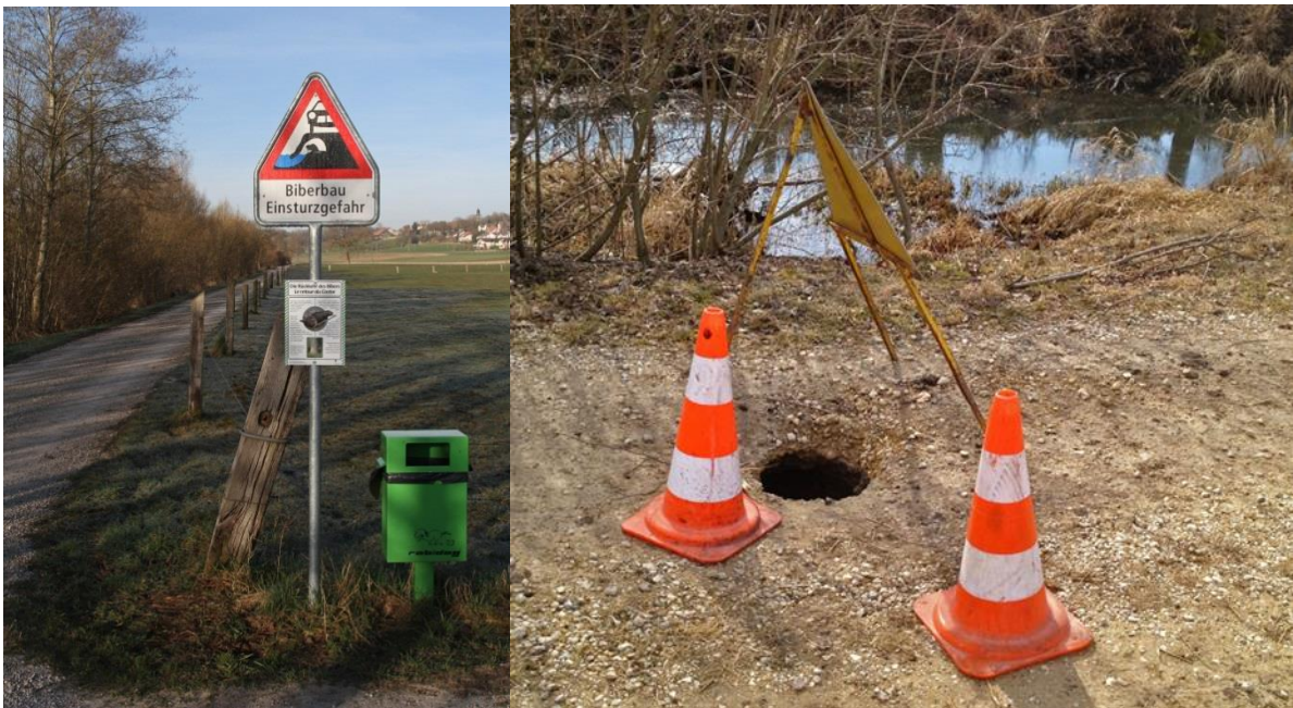
Bild 4: Markierung eines eingestürzten Flurwegs. (Fotos: WaldA, E. Bürgy).
