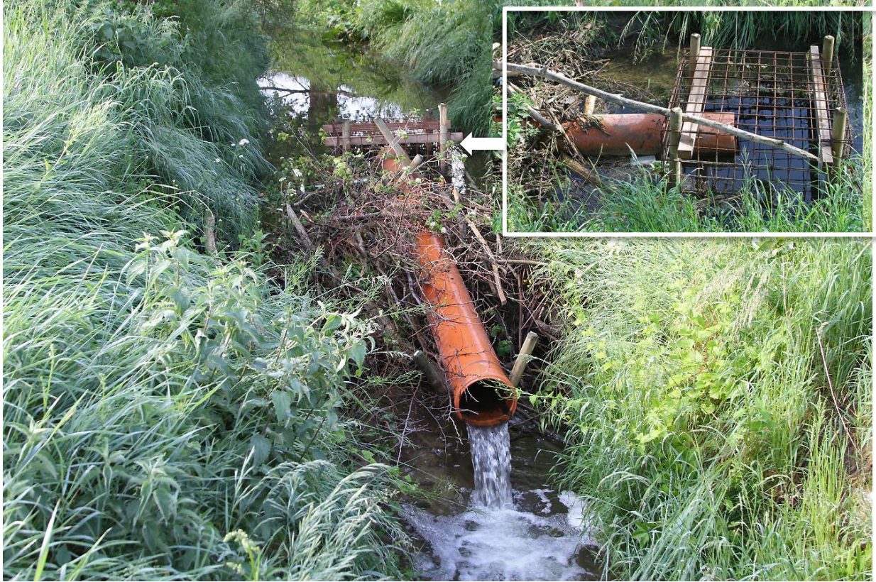
Bild 1: Ein durch einen Biberdamm gelegtes Rohr ermöglicht den normalen Wasserabfluss. Ein Gitter rund um die Eingangsöffnung verhindert, dass der Biber die Öffnung verstopft. (Foto: WaldA).
