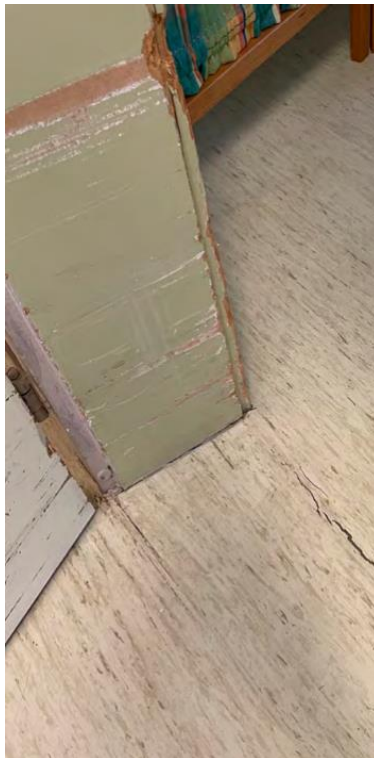
Schäden im Inneren
