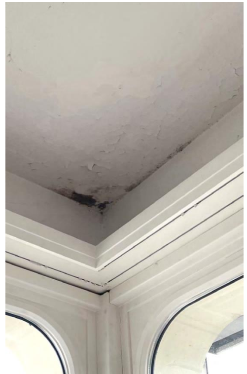
Schäden im Inneren
