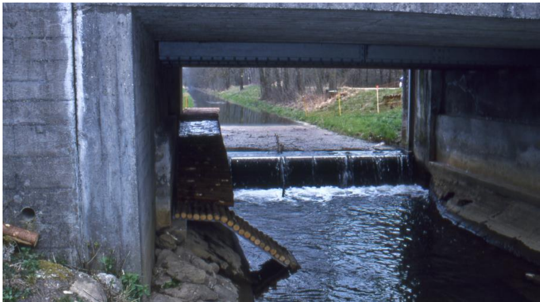
Bild 7: Diese 40 cm hohe Schwelle am Hauptkanal im Seeland war für den Biber unüberwindbar. Fünf Biber wurden oberhalb des Tunnels auf der Strasse überfahren. Nach der Installation der links auf dem Bild sichtbaren Rampe, kam es zu keinen Unfällen mehr (Angst 2009).
