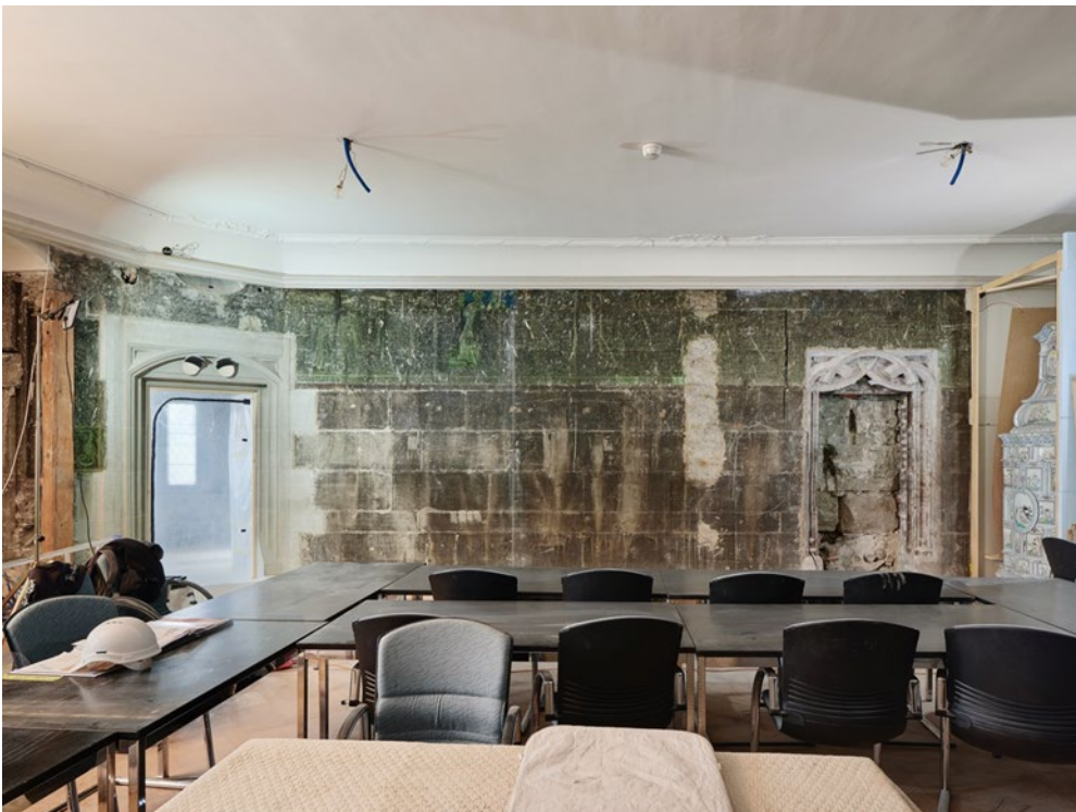
découverte de fresques remarquables au 1 er étage et d'une porte murée inconnue, mur contre la tour de l'horloge (anc. tribunal cantonal)
