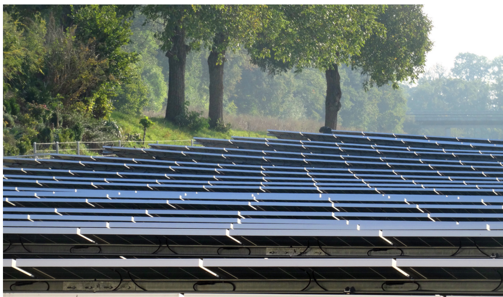
Foto 4.3: PV-Freiflächenanlage mit 6 MW Leistung in Payerne (VD), in Betrieb seit September 2015. Quelle: NET AG
